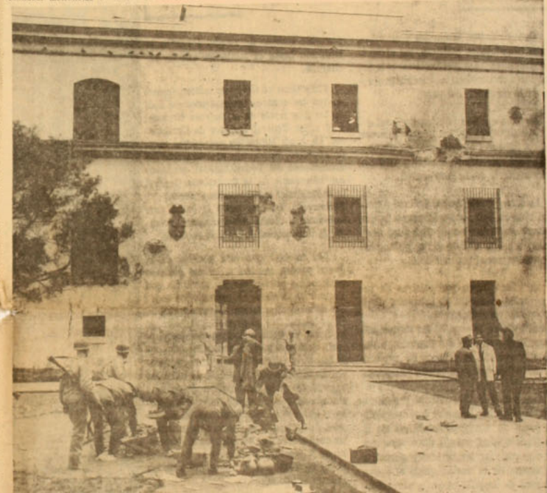
En el Patio de Los Naranjos, del Palacio de Gobierno, se observan paredes quemadas e impactos de los proyectiles que lanzó la Fuerza Aérea de Chile.
